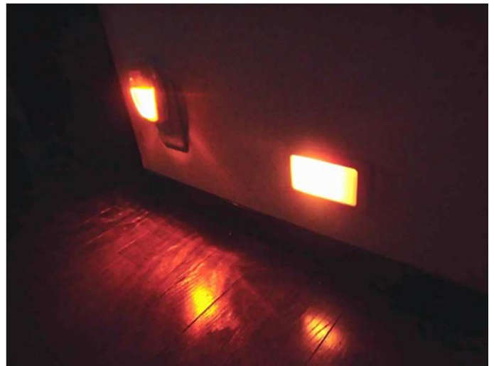
画2 廊下の夜間点灯(右：埋込型、左：コンセント設置)
